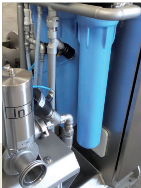
Filtración agua de lavado
