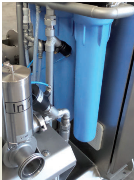
Filtration des Waschwassers
